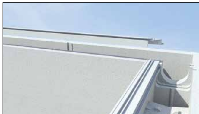
26 Pose du rail d'accrochage du liner, avec coupe à 45° des rails dans les angles
